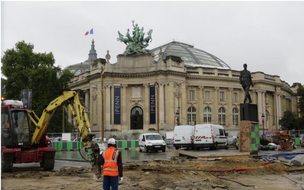
Gros travaux au Grand palais. Une nouvelle sortie du métro est en train d'être creusée. En même temps, l'étanchéité de la station est en cours.
