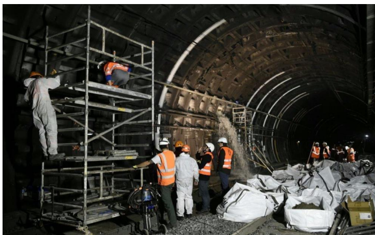
Le 30 octobre dernier dans le tunnel du RER A percé par erreur par des ouvriers du chantier Eole porte Maillot. DR
