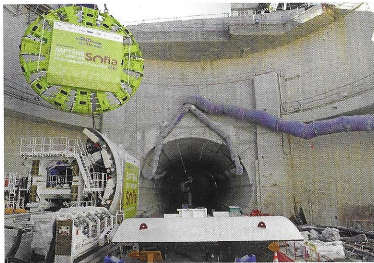
La foreuse de 100 m de long creuse et bâtit le tunnel de la ligne 11.
